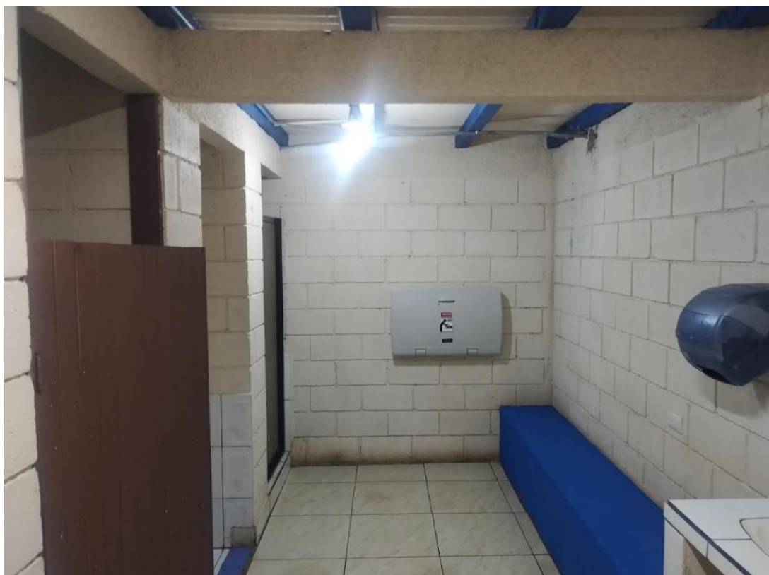
Condición actual de los servicios sanitarios
