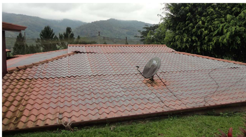
Imagen 1. Techo salón multiusos a sustituir
