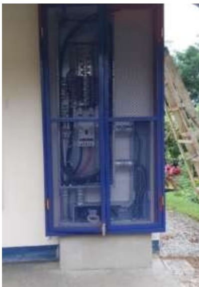
Fig # 5. Tableros eléctricos nuevos.
