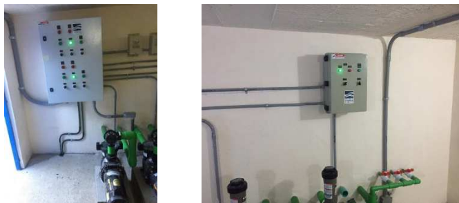
Fotografías # 6 # 7. Controles eléctricos.
