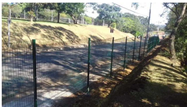
Fotografía # 1. Imagen general de la malla decorativa instalada.
