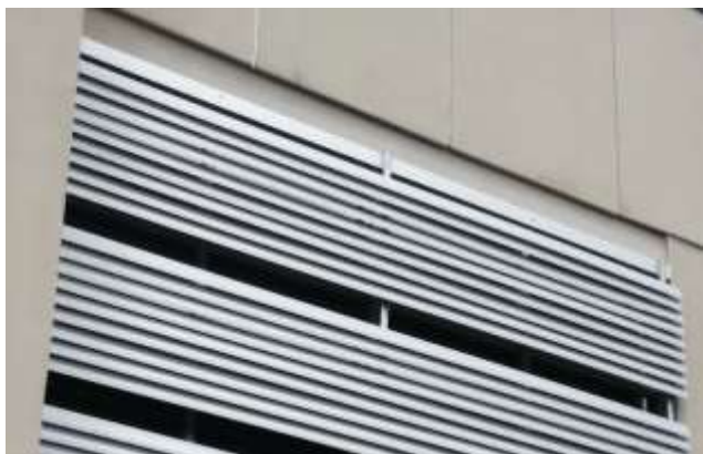
Fig#10. Colocación actual de los parasoles.
